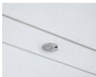
ÉCLAIRAGE ET LUMINAIRES
