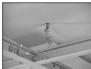
Il faudra peut-être ajouter des fils de suspension au treillis pour supporter le poids des appareils d'éclairage
